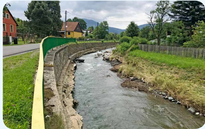
Bělá ř. km 24,150, pohled proti vodě po povodni
